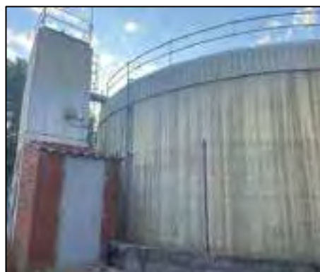
Imatge 7. Dipòsit General ATLL
