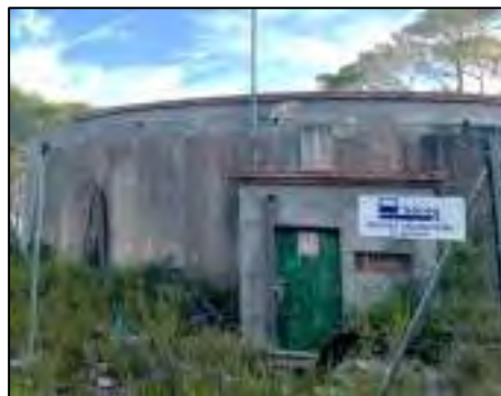
Imatge 16. Dipòsit Alt Vora Sitges
